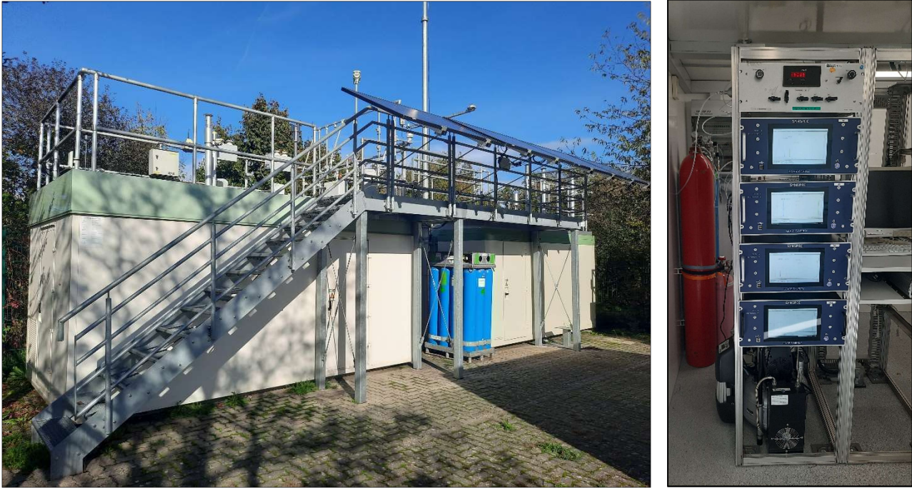
Abb. 4.1: Messstation auf dem Versuchsgelände der LUBW
