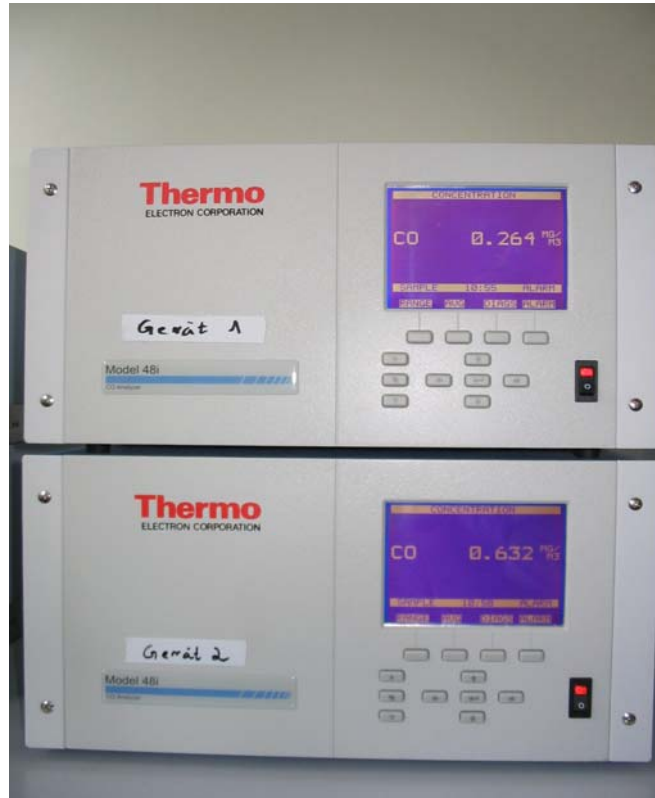
Abbildung 3: Frontaufnahme der im Messcontainer installierten Messeinrichtungen
